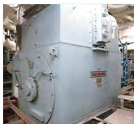
推進電動機 Propulsion motor
