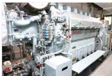
主発電装置 Main generator set
